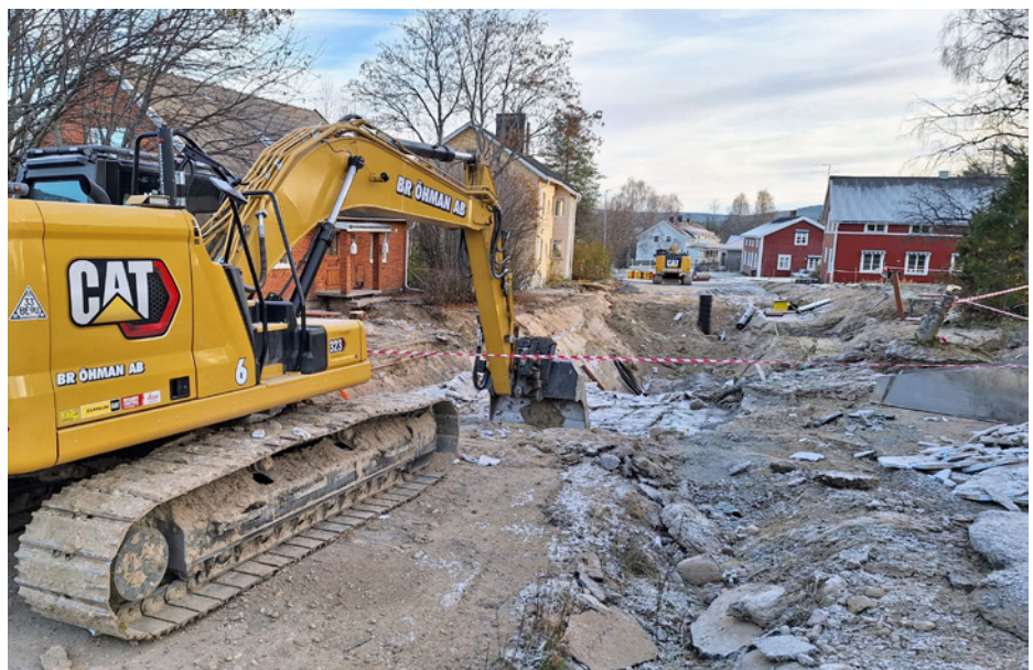
Entreprenör för upprustningen av Gammelvägen är Br. Öhman AB. Foto: Peter Lundberg.
